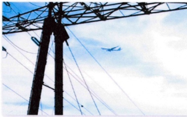
Figure 3 - Obstacles filiformes : Lignes électriques, lignes de télécommunication, etc.
